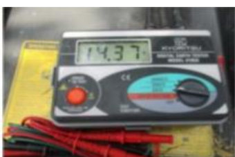
1. เครื่องมือทดสอบค่ากราวด์ของหม้อแปลงไฟฟ้า
